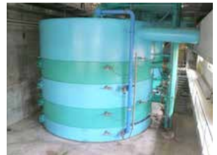
Ansicht nachgeschalteter Sandfilter
